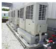
種苗センター 塩害対策用冷却加温ユニット
