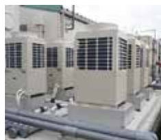
種苗生産施設 塩害対策用冷却ユニット
