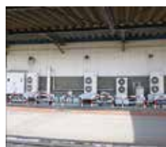
卸売市場 活魚水槽用冷却加温ユニット
